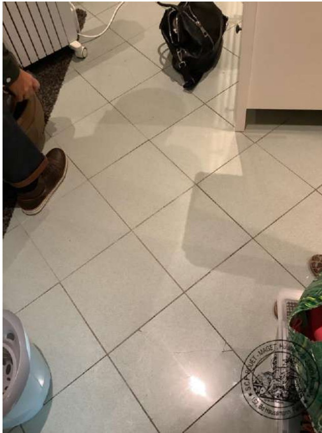
Présence de fissure sur le carrelage
