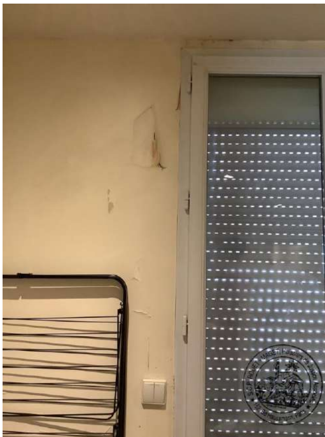
Cloquage de la peinture à gauche de la fenêtre
