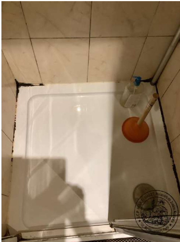
Les joints dans la cabine de douche sont largement noircis.
