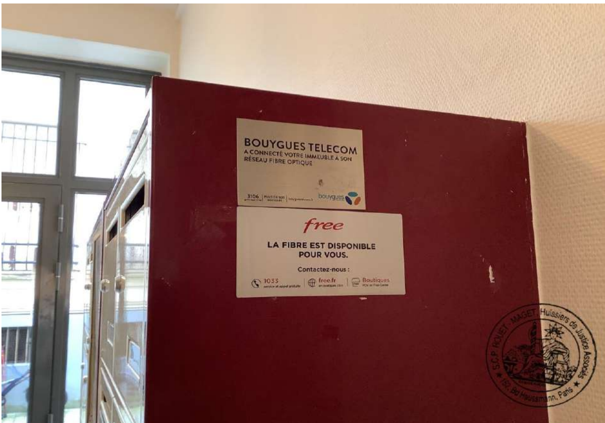
L'immeuble est équipé de la fibre optique
