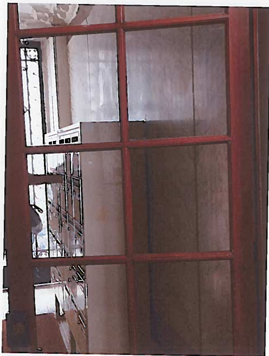
La porte d'entrée de l'immeuble à deux vantaux avec verres cathédrale protégés par une grille métallique est équipée d'une serrure à gâche électrique. L'ensemble est en bon état.
